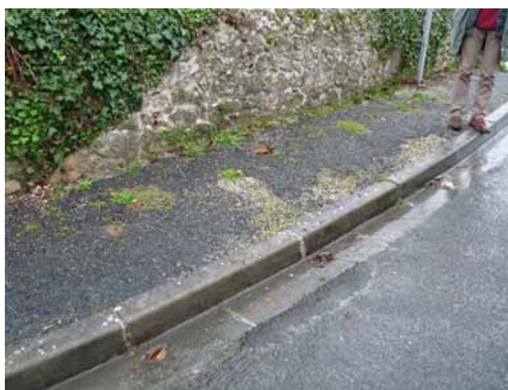
Trottoir à rénover
